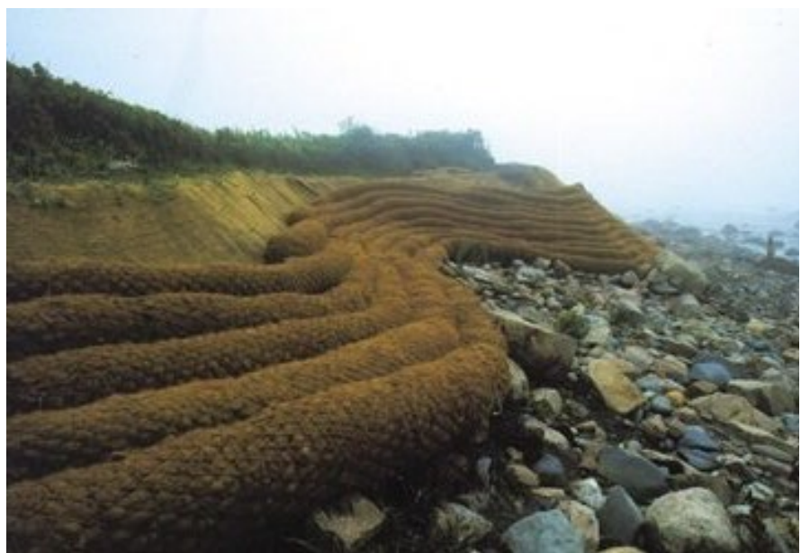
Proceso de estabilización de un talud en Massachusetts. Fuente: New England Environmental.
