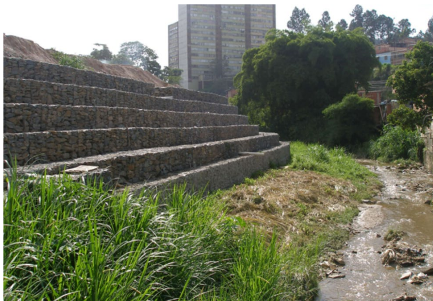
Estabilización de los márgenes del Río San Pedro, Los Teques, Venezuela. Fuente: EcoGreen Construcciones.
