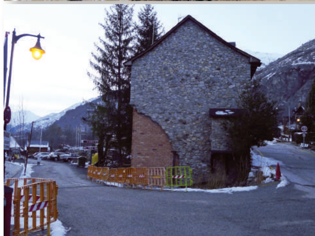
Figura 72. Edificio afectado por la riada de junio de 2013 en el Valle de Arán (Lleida), antes y después de su reconstrucción. Fuente: CCS.
