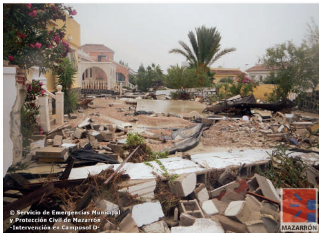
Figura 34. Efecto combinado de empuje y erosión. Muro derruido en Mazarrón (Murcia), inundaciones de 2014. Fuente: Servicio de Emergencias Municipal y Protección Civil de Mazarrón.
