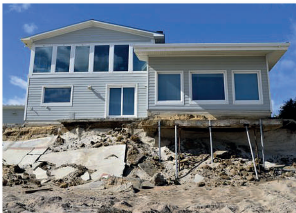
Figura 33. Descalce de la cimentación del edificio por erosión debida al embate de mar.
