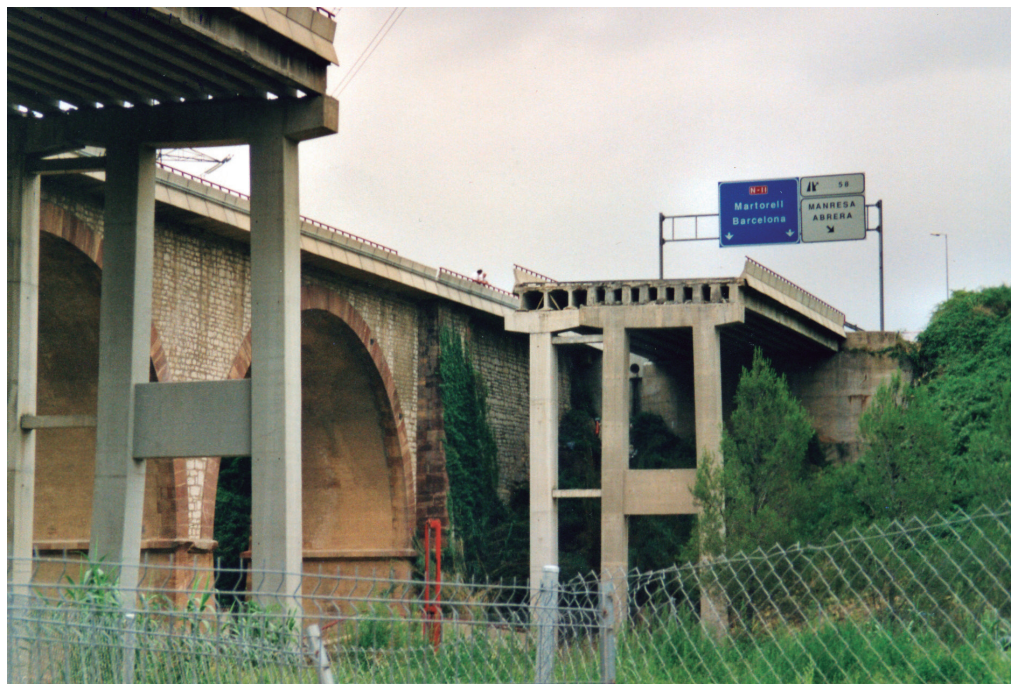
Un puente de la carretera nacional II destruido después de los aguaceros del 10 de junio de 2000.
