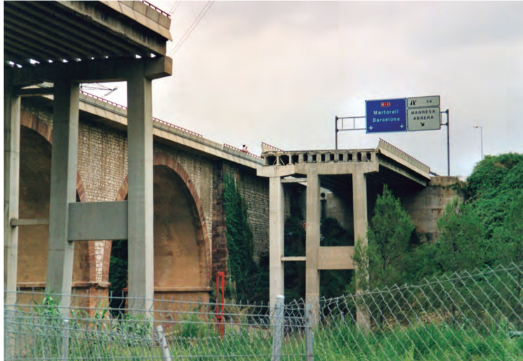
Un pont de la carretera nacional II destruït després dels aiguats del 10 de juny de 2000.
